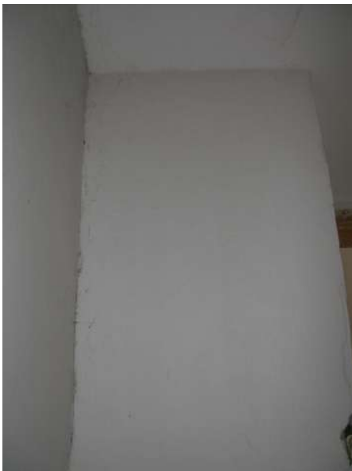
Vnější pohled na schodiště – zespoda ze spodního schodiště domu (podbití, omítka), nahore půda
