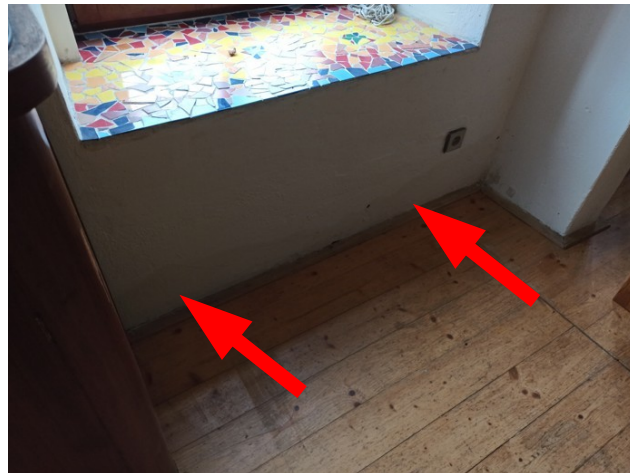
foto/30/ Pohled na vlhkostní mapu na obvodové stěně
