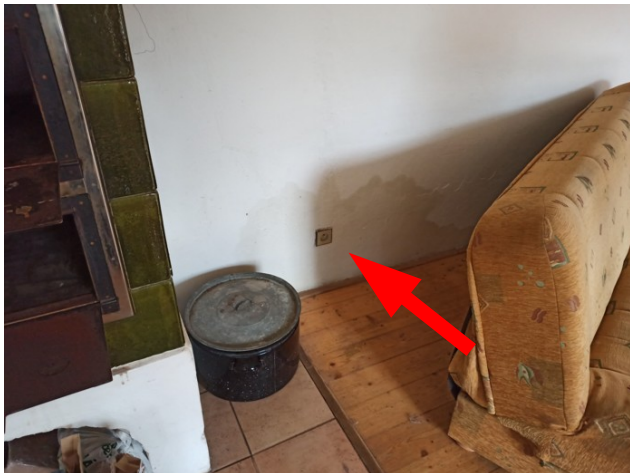
foto/29/ Pohled na vlhkostní mapu na vnitřní stěně
