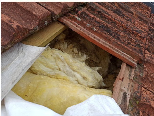
foto/15/ Absence DHV po demontáži střešních tašek
