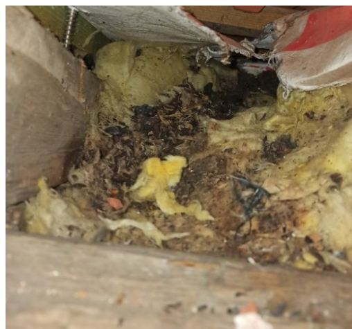
foto/20/ Pohled na trusy od živočichů na tepelné izolaci
