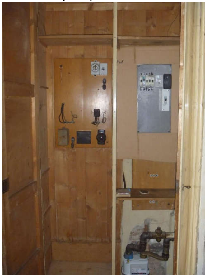
Pohled do instalační šachty s plynoměrem a bytovým rozvaděčem
