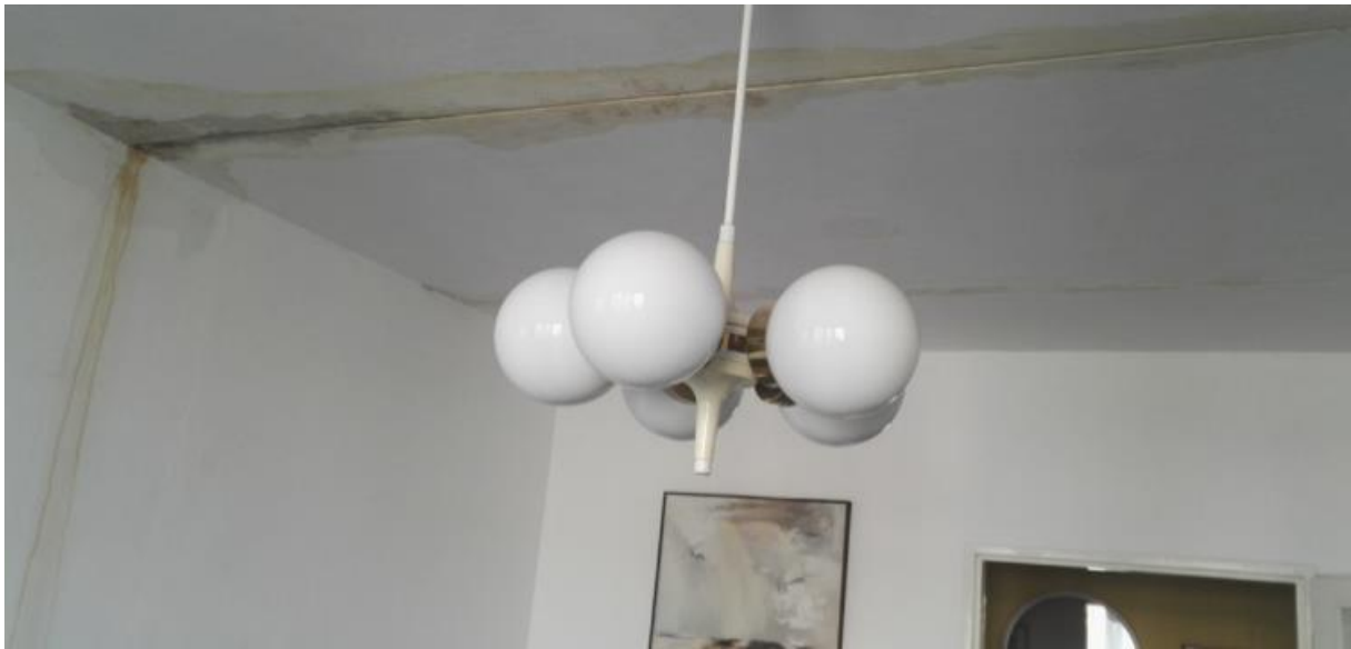
Strop obývací pokoj – nutná oprava
