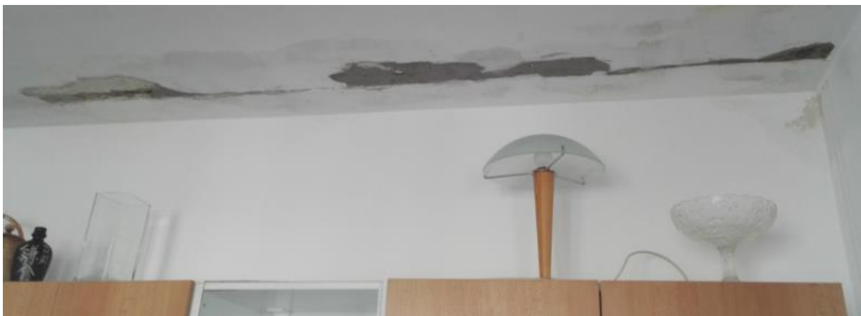
Strop kuchyně – nutná oprava
